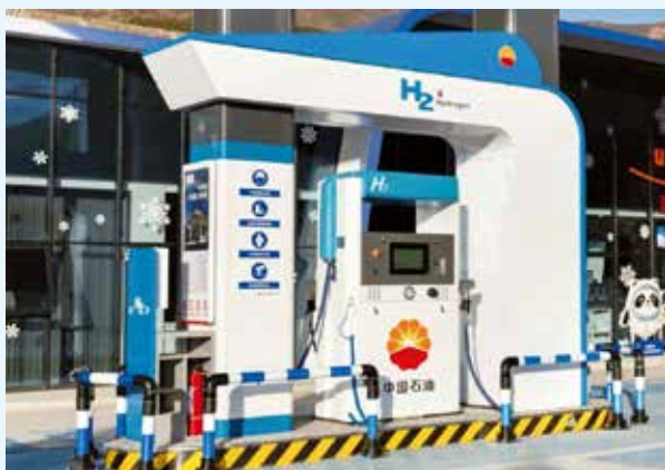
综合站的加氢装置
