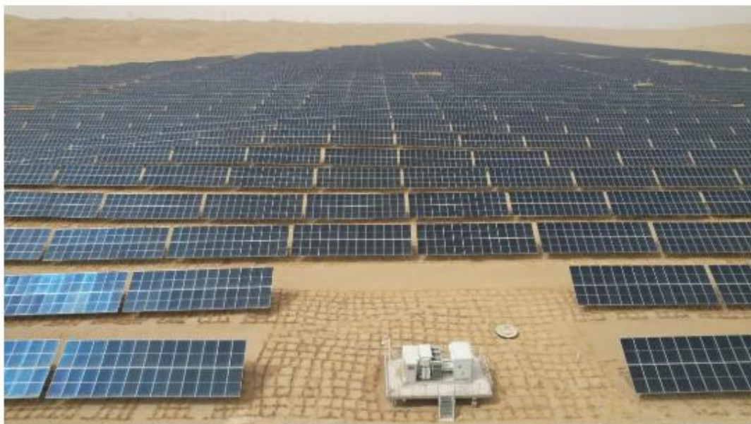
塔里木油田且末10万千瓦光伏发电现场
